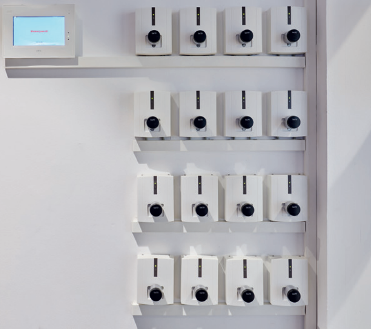
Elektronischer Zylinder als Mechanik-Ersatz: Hier in den Schliessschaltern einer Einbruchmeldeanlage.
