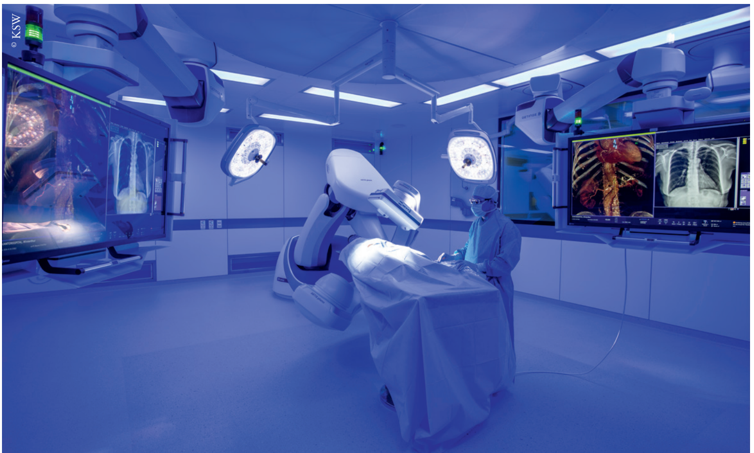
Beispiel eines Hybrid-OP-Saals mit rundem Luftauslass, Kantonsspital Winterthur
