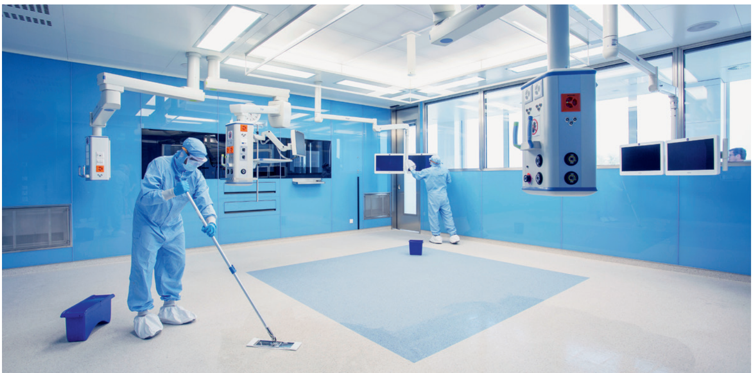
Beispiel eines Schutzgrad-OP-Saals mit quadratischem Luftauslass, Kantonsspital Münsterlingen
