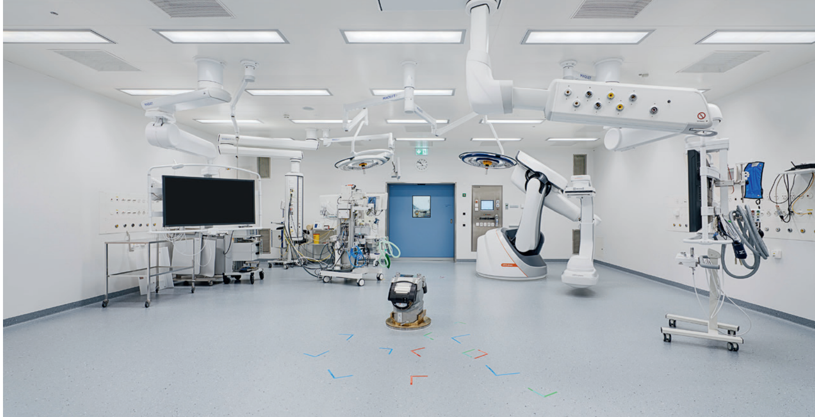
À l'hôpital cantonal de Lucerne, les salles d'opération sont également conçues de manière professionnelle et modulaire.
