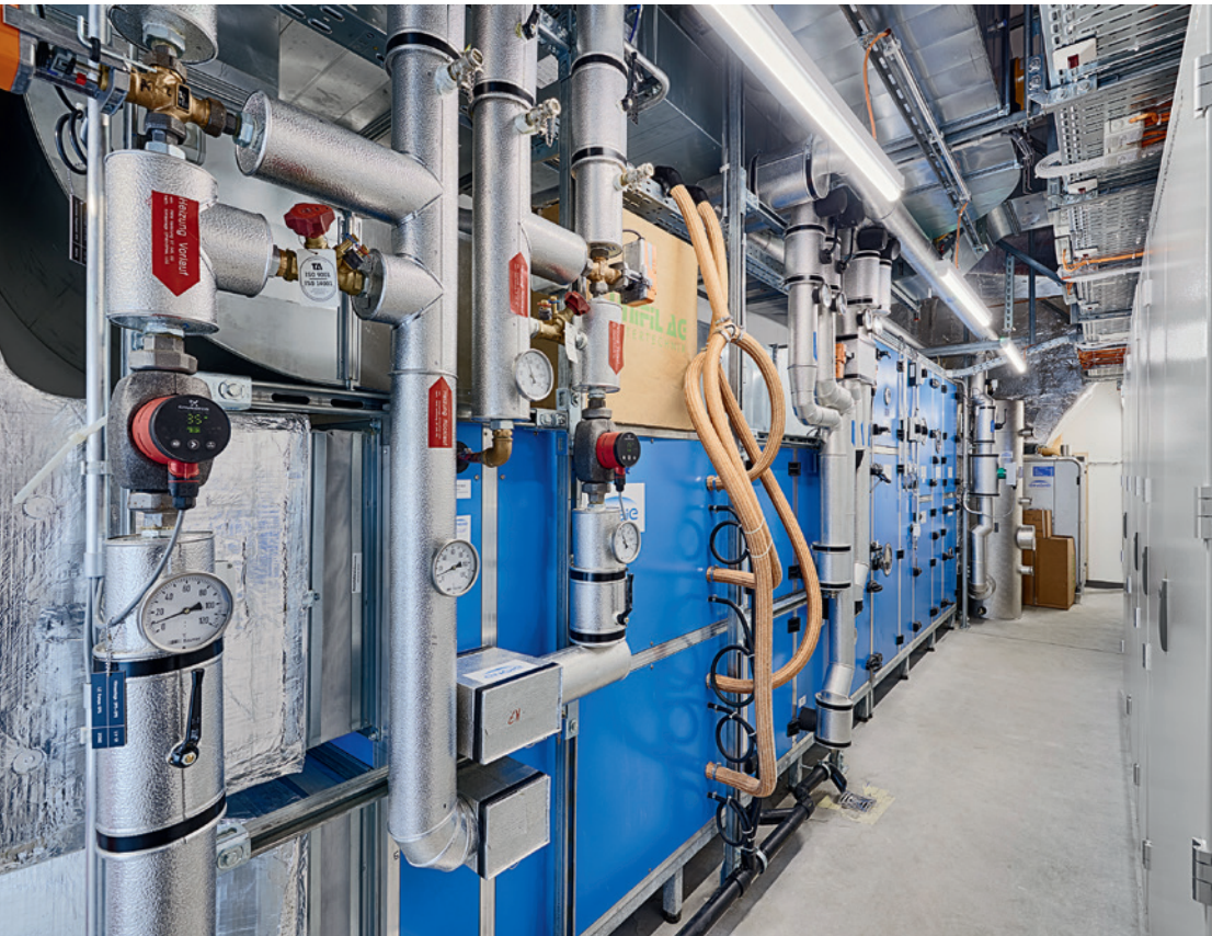
Aperçu de la technique complexe d'une salle d'opération de la clinique Hirslanden Stephanshorn à Saint-Gall
