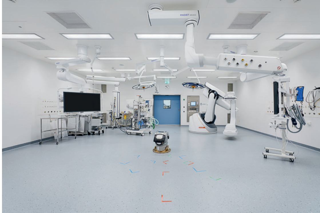
Auch im Luzerner Kantonsspital sind die Operationsräume fachgerecht und modular aufgebaut.
