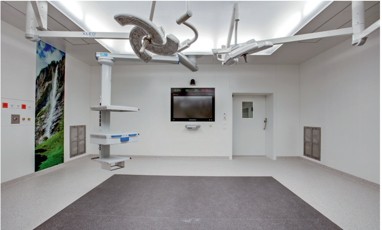
Les onze salles d'opération de l'HRC sont équipées d'une technologie de pointe. Elles sont situées aux deux premiers étages du bâtiment de l'hôpital.
