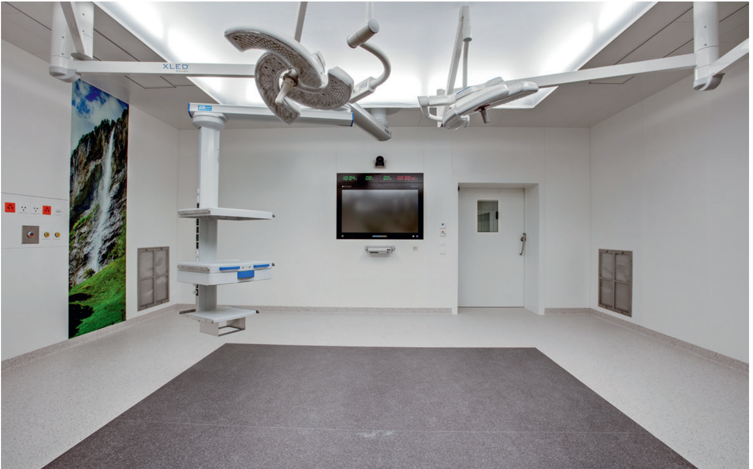
Die elf Operationsäle des HRC sind mit modernster Technik ausgerüstet und befinden sich auf den ersten beiden Etagen des Spitalgebäudes.
