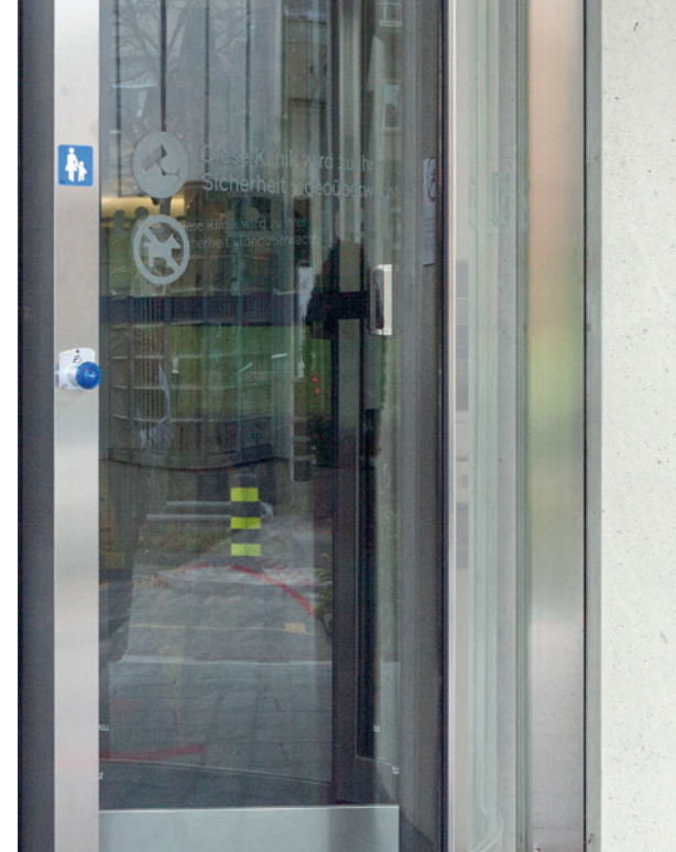
Zutrittskontrolle am Haupteingang der Klinik Hirslanden Zürich über ...
