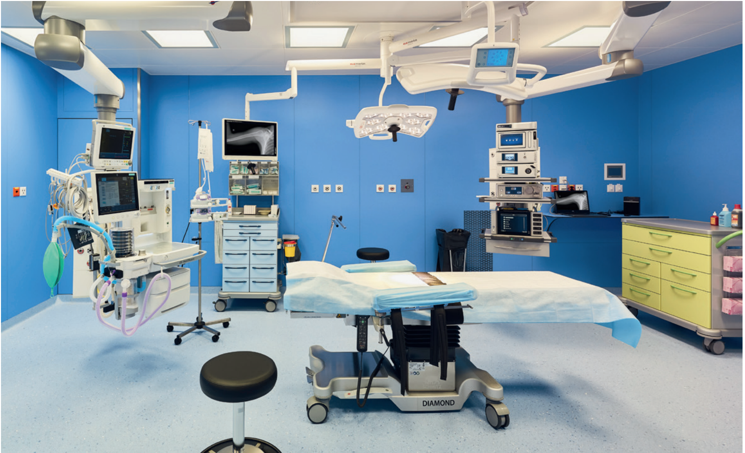
Modernste OP-Technik: Höchste Funktionalität dank Deckeninstallationen und klare gestalterische Linien bringen Prozessoptimierung und Ästhetik harmonisch zusammen.
