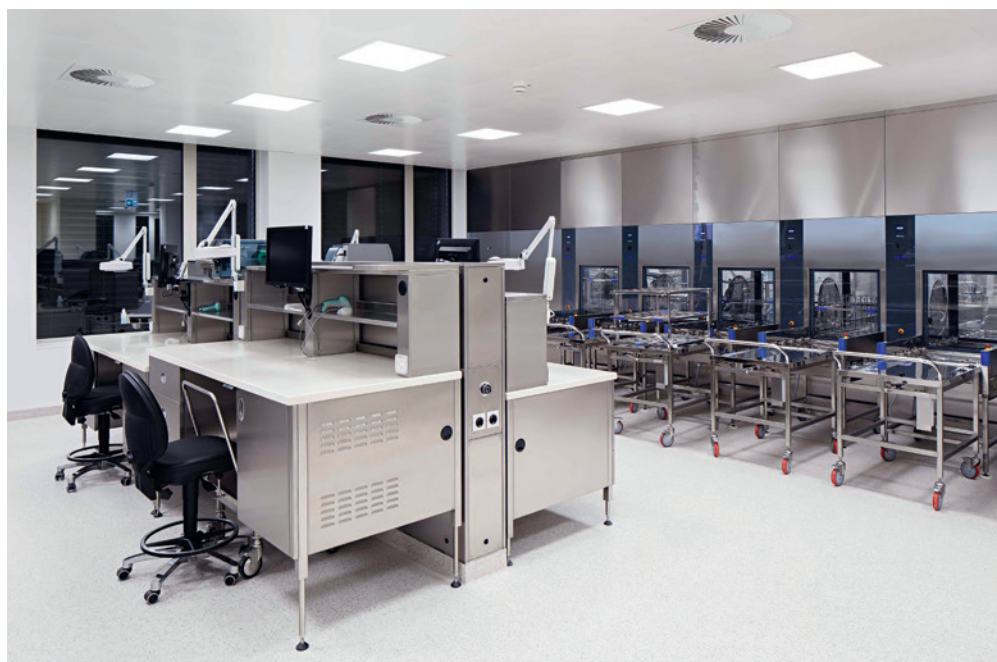
Zentrale Sterilgut-Versorgungsanlage für beiden Kantonsspitäler Frauenfeld und Münsterlingen im Neubau 3i.
