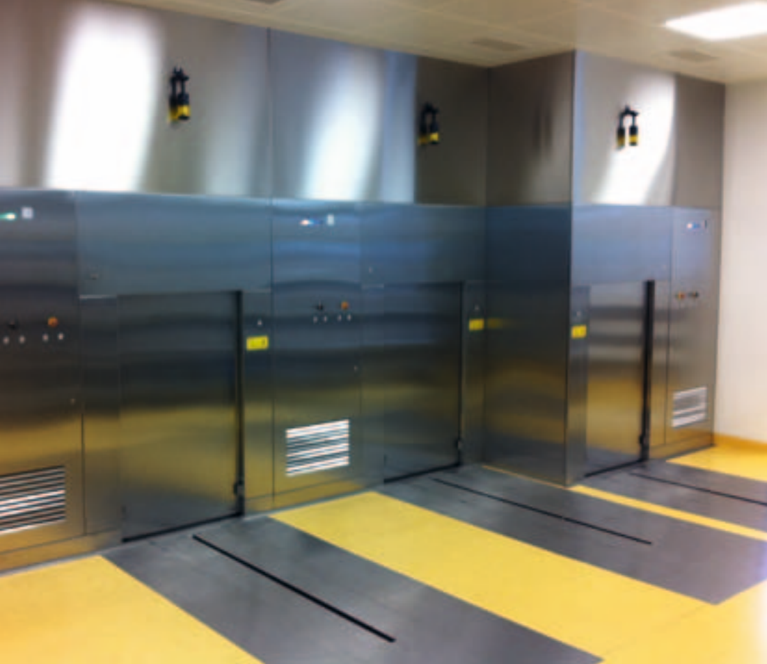
Die Wagen mit den fertig sterilisierten Instrumenten werden automatisch aus der Anlage herausgefahren.
