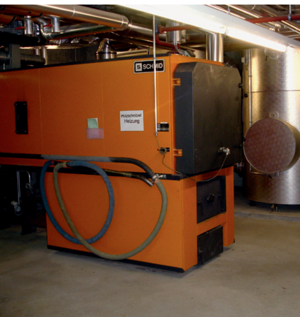
Holzschnitzel optimieren den Energieeinsatz.
